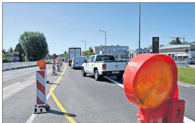
Straßensanierung: Neuer Asphalt und kleinere Staus auf der B39 in Richtung Industriestraße. FOTO: LENZ
